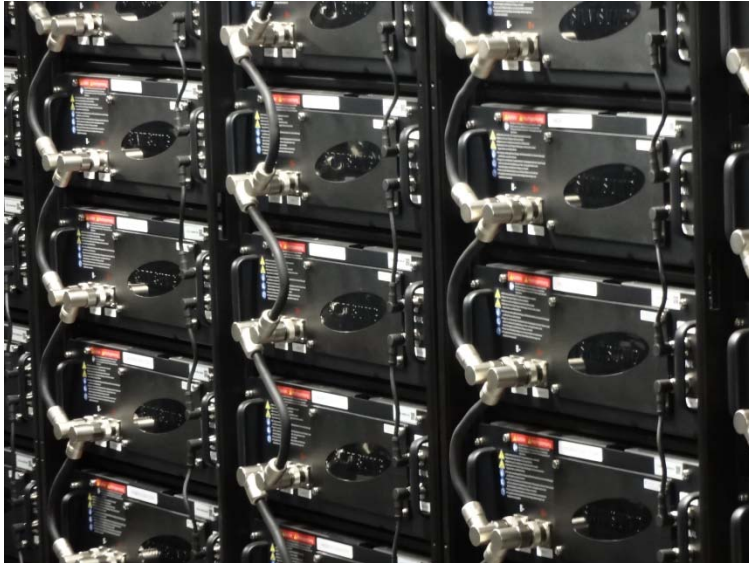
Abbildung 1: Konventioneller Aufbau eines Großspeichers (5 MWh, Wemag, Schwerin) bestehend aus Niederspannungsmodulen.
