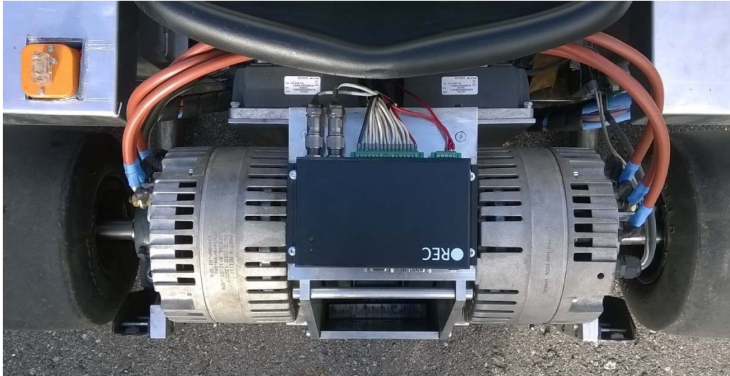
Abb. 2.03: Verkabelung Motor, Regler, BMS
